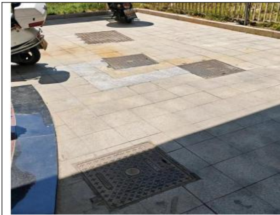
地埋式一体化污水处理设施
